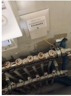
Géothermie, fibre optique
